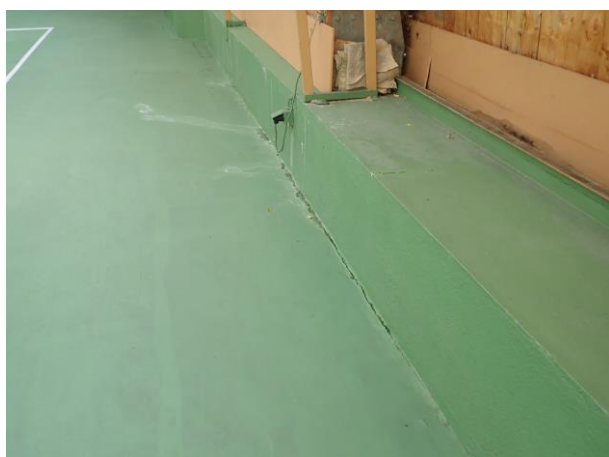
Obr. 20 Podélná spára u stěnového pásu
